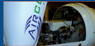
Maschinengeländer einer Aircon Windkraftanlage mit horizontaler Rotationsachse. Deutlich zu sehen: die Knott Federspeicher Feststellbremse
